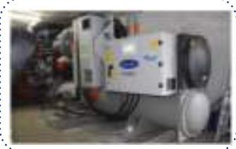
Figura 9.2: Sistema de Climatización
